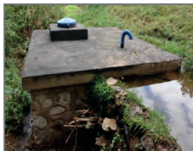
Captage d'eau (Source : ONEE-Eau)
