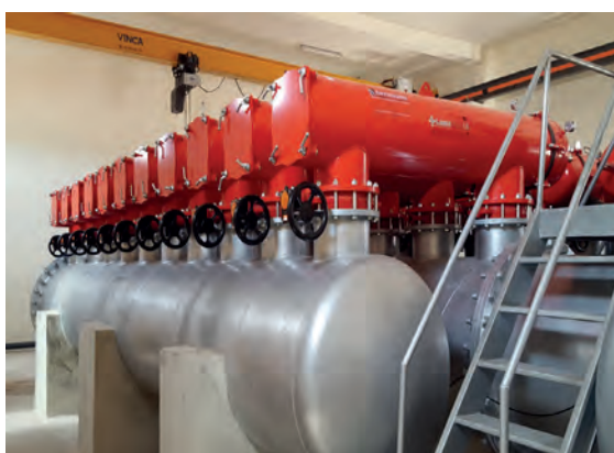
Photo 9 - Modernisation de l'agriculture : équipement de la station de tête pour l'irrigation localisée, N'fis, Marrakech Source : RESING
