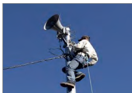
Installation des alarmes d'alerte en cas de crues (Source : ABHT)
