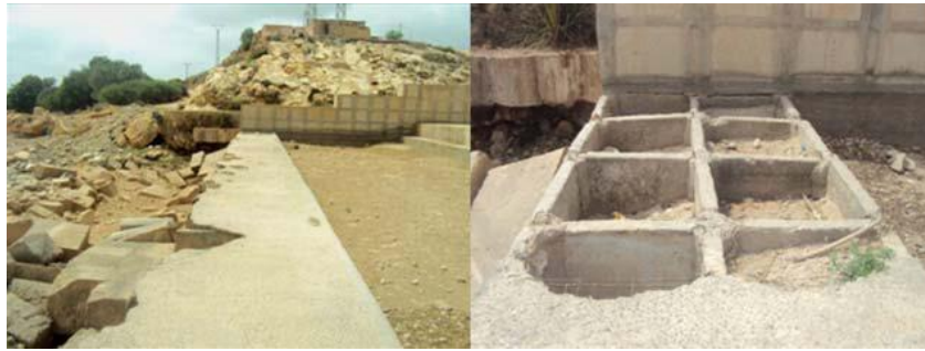
PHOTO 2: DEGRADATIONS DU SEUIL TALKJOUNT (NAPPE DE SOUSS)
